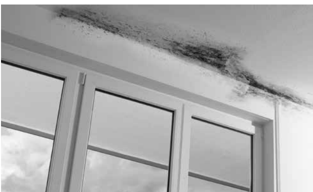
Erhöhung des Schimmelpilzrisikos
