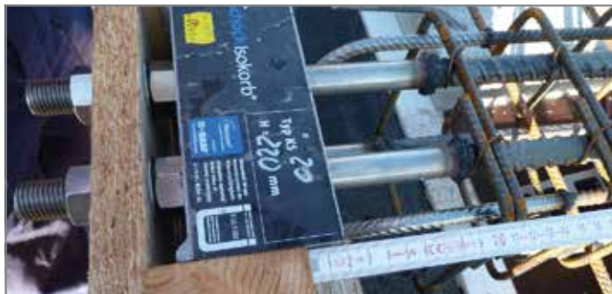
Abb. 24: Verwendung der optionalen Einbauhilfe von Schöck beim Einsatz in Verbindung mit Wärmedämmverbundsystem. Ansicht zeigt Befestigung an der Deckenrandschalung
