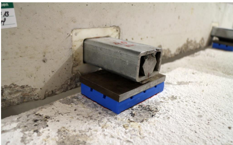
Abbildung 6: Elastomerlager Elodur® 1050 aus Schöck Tronsole® Typ Q entnommen zur Auflagerung der Laufhülsen auf der Hilfswand
