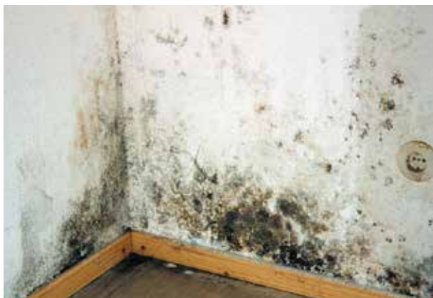
Schimmelpilzbildung ungedämmter Gebäudesockel
