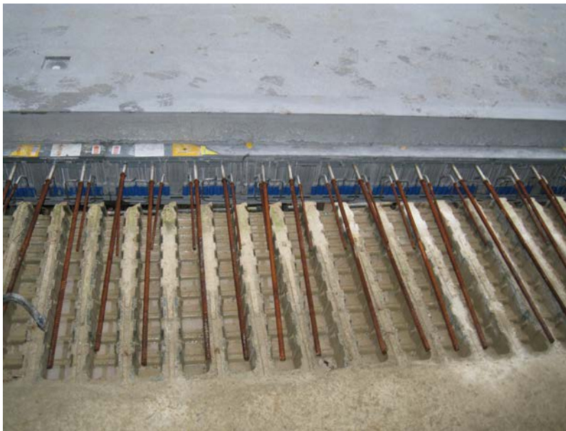
Der Fertigteilbalkon mit integriertem Schöck Isokorb ID wird in die vorgesehenen Öffnungen platziert.
