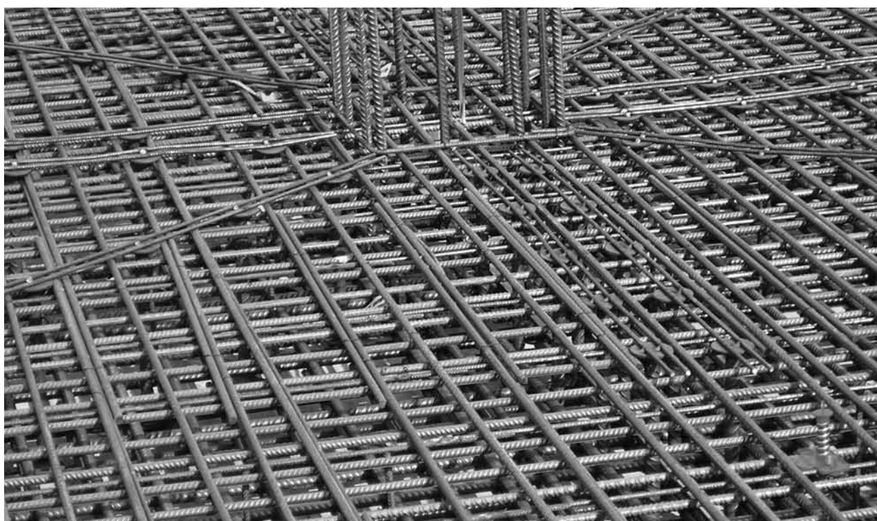
Schöck Bole® Typ O: Verlegung bei engsten Platzverhältnissen. Einbau erfolgt von oben nach der Verlegung der kompletten Bewehrung.
